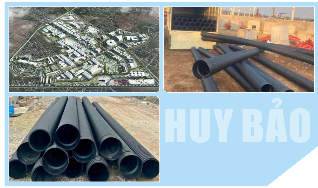
Hệ thống đường ống công trình
